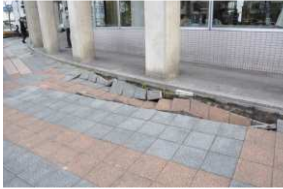
春日部市教育センターの被害状況
