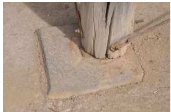
市内寺院楼門の柱の軸部が礎石上で移動
