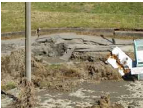
地震により液状化した道路 (幸手市 平成23年)
