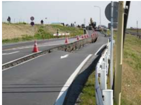
県道の地割れ (幸手市 平成 23 年)
