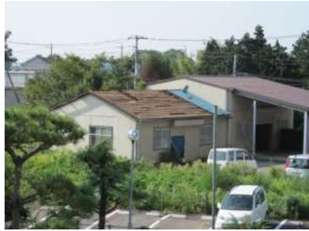
屋根が吹き飛んだ文化財保管庫（松伏町）
