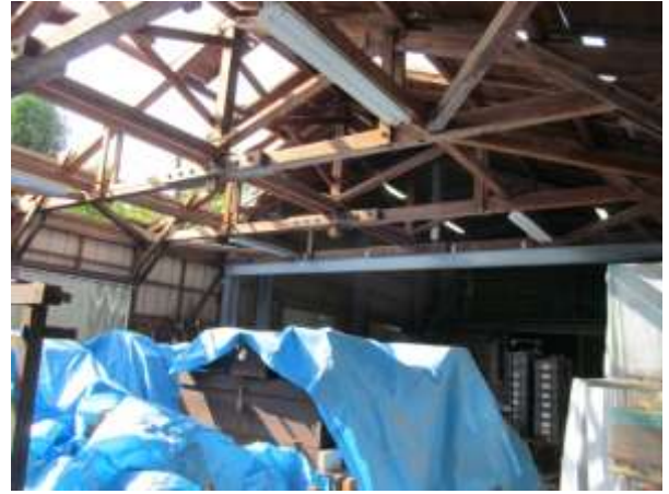
浸水した文化財保管庫（松伏町）
