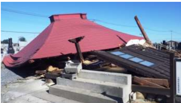
倒壊した浄安寺の地藏堂（熊谷市）
